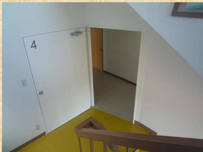
新設の防火扉
