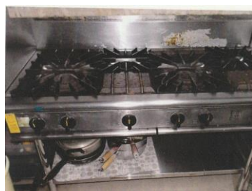
古い4口のガス台
