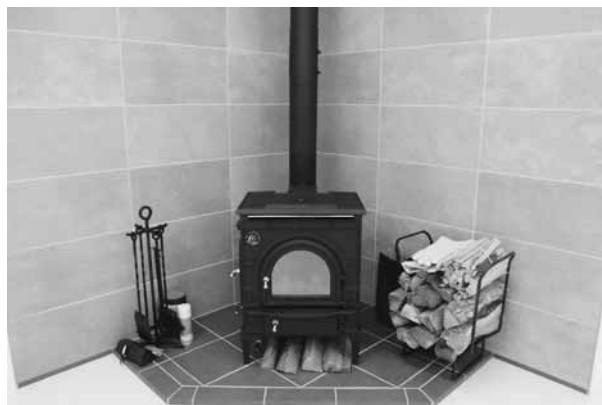
【事務室内には薪ストーブの設置】
